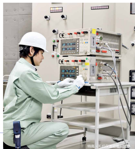
特高 系統設備の点検
