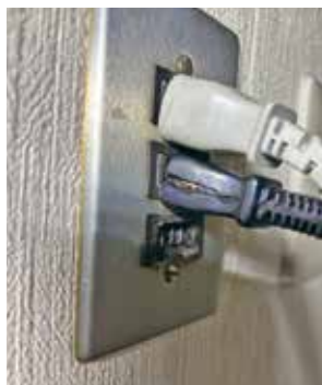
破損していたプラグ
