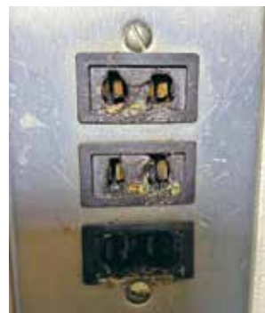
コンセント差し込み口の焼損跡
