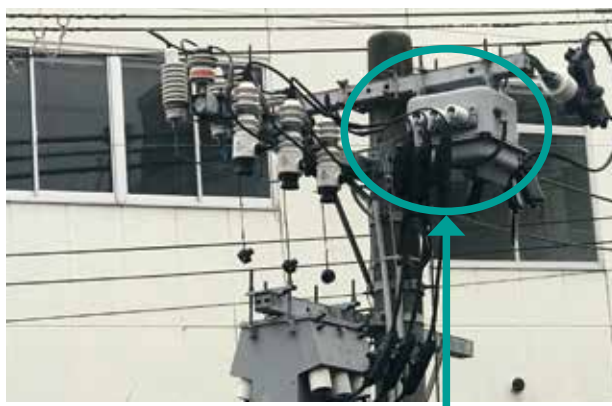
停電の原因となった高圧区分開閉器
