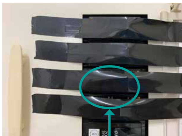
原因箇所の分電盤（切れていたブレーカー）
