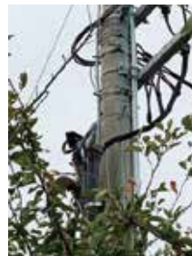
枝が電柱に接触
