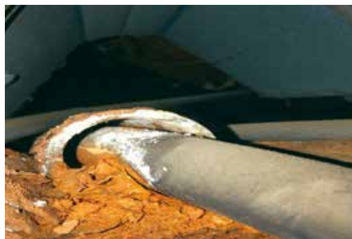
雨水の浸入等により腐食した高圧ケーブル
