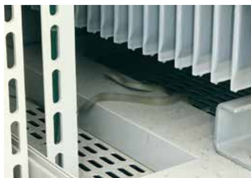
変圧器の下にいた蛇
