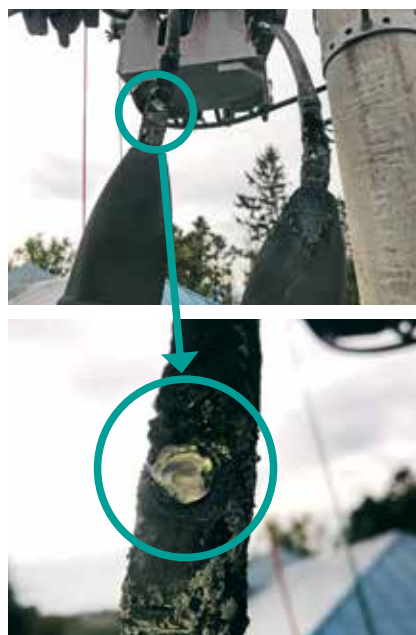
高圧ケーブル接続部の充電部露出箇所
