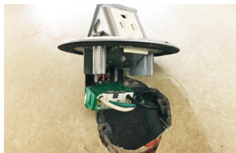
点検すると中に水が溜っていました
