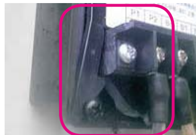
DGR端子台の破損状況
