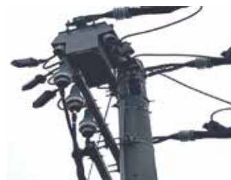
高圧気中負荷開閉器
