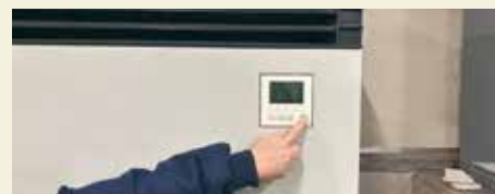
第8工場エアコン操作パネル
