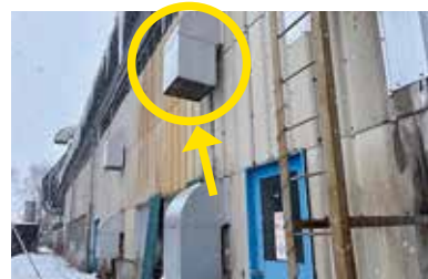
リスが侵入したと思われるダクト
