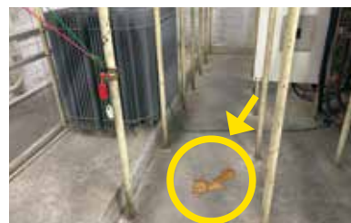
電気室内の様子（リスはイメージ）
