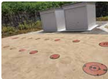
マンホールトイレ・倉庫
