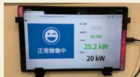
3か所に設置した警報表示器(タブレット)
