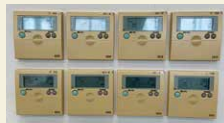
手動停止するエアコン操作パネル
