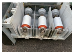
異常のあった真空遮断器（VCB）
