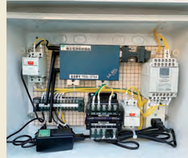
自動制御装置
